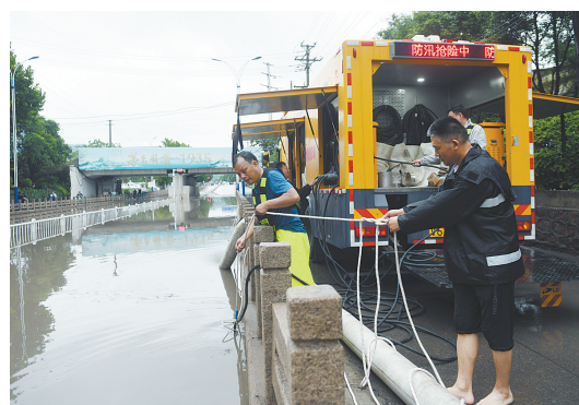
7月16日早上6点多,工作人员在市区东环路北段铁路涵洞排水。
