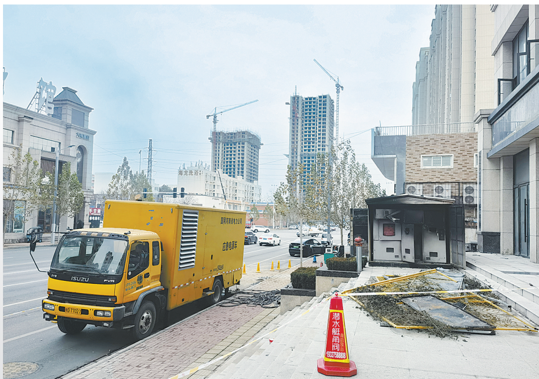
12月18日下午,原变压器附近,应急电源车给小区提供临时供电。
