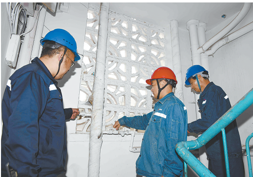
市区曙光街一居民小区楼道内,热力人员正在检查供热管道。
