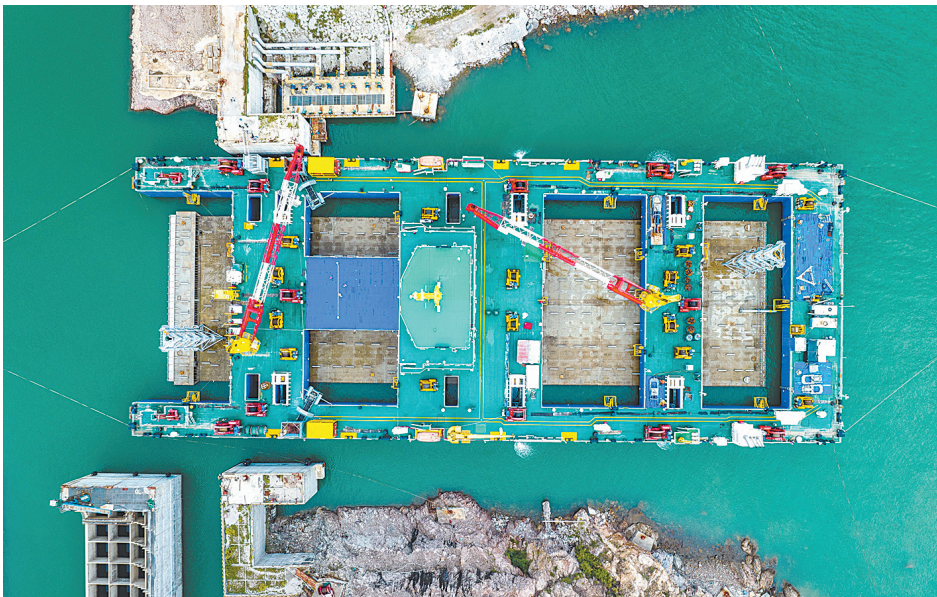
“一航津安1”号沉管运输安装一体船拖带E23管节和最终接头从珠海桂山岛启航，前往沉放水域(6月8日摄，无人机照片)。
