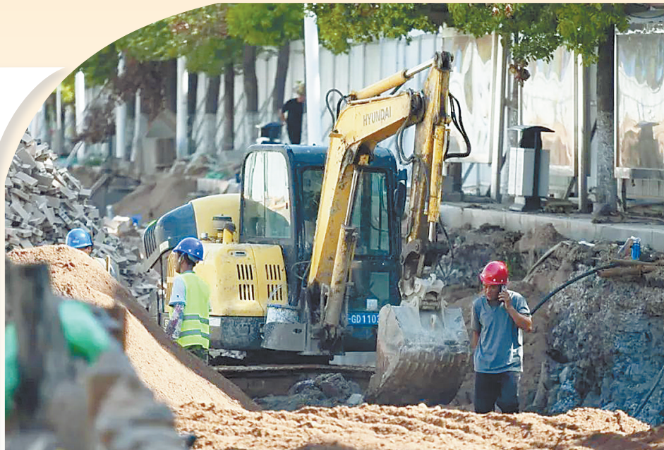
2022年7月，市区凌云路中段积水点改造现场，挖掘机正在忙碌施工。
