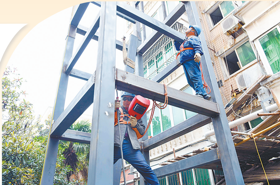
日前,西高皇街道园林路社区居民楼加装电梯施工现场。本报记者 张鹏 摄
