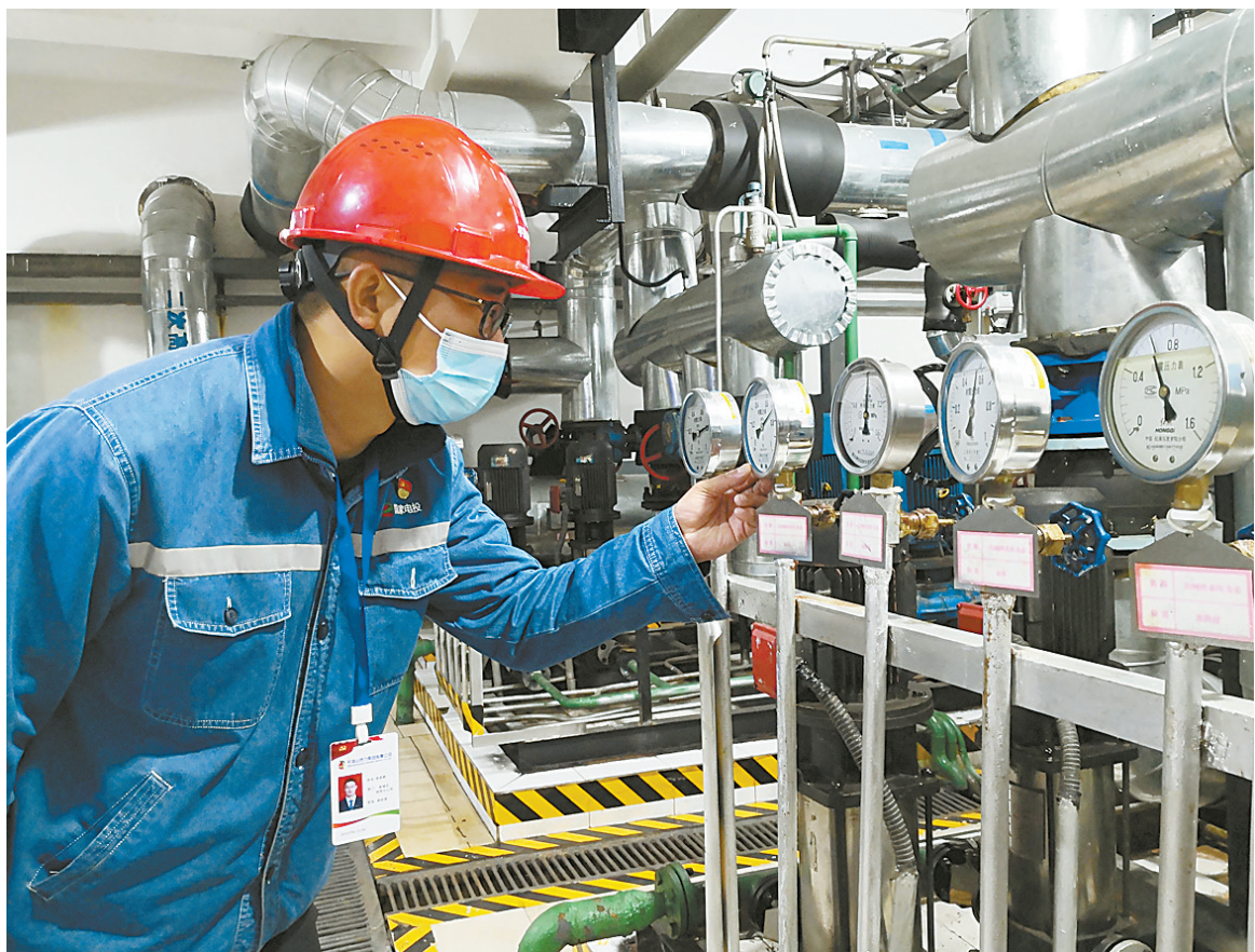
工作人员在换热站查看运行数据
