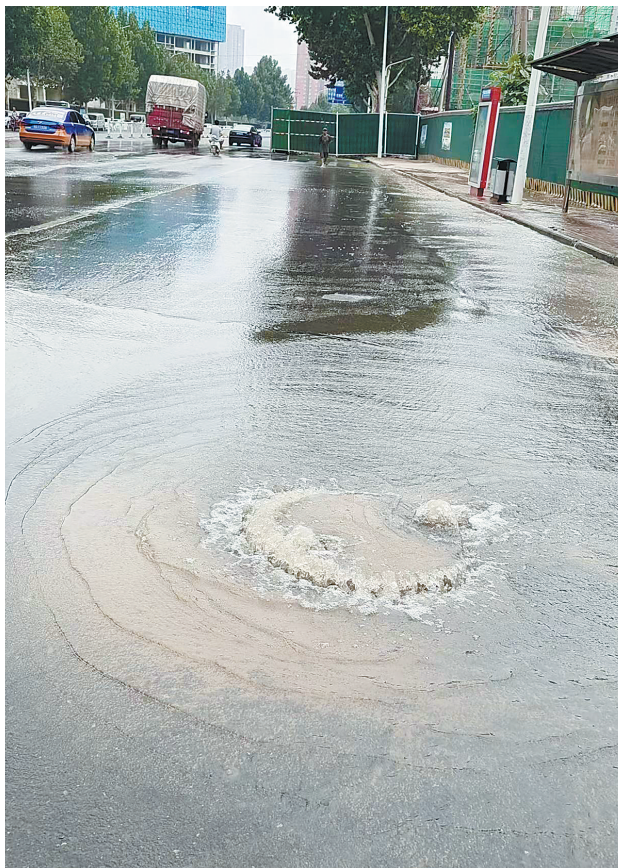
7月13日,姚电大道与亚兴路交叉口附近一处自来水管破裂,大量水冒出地面
