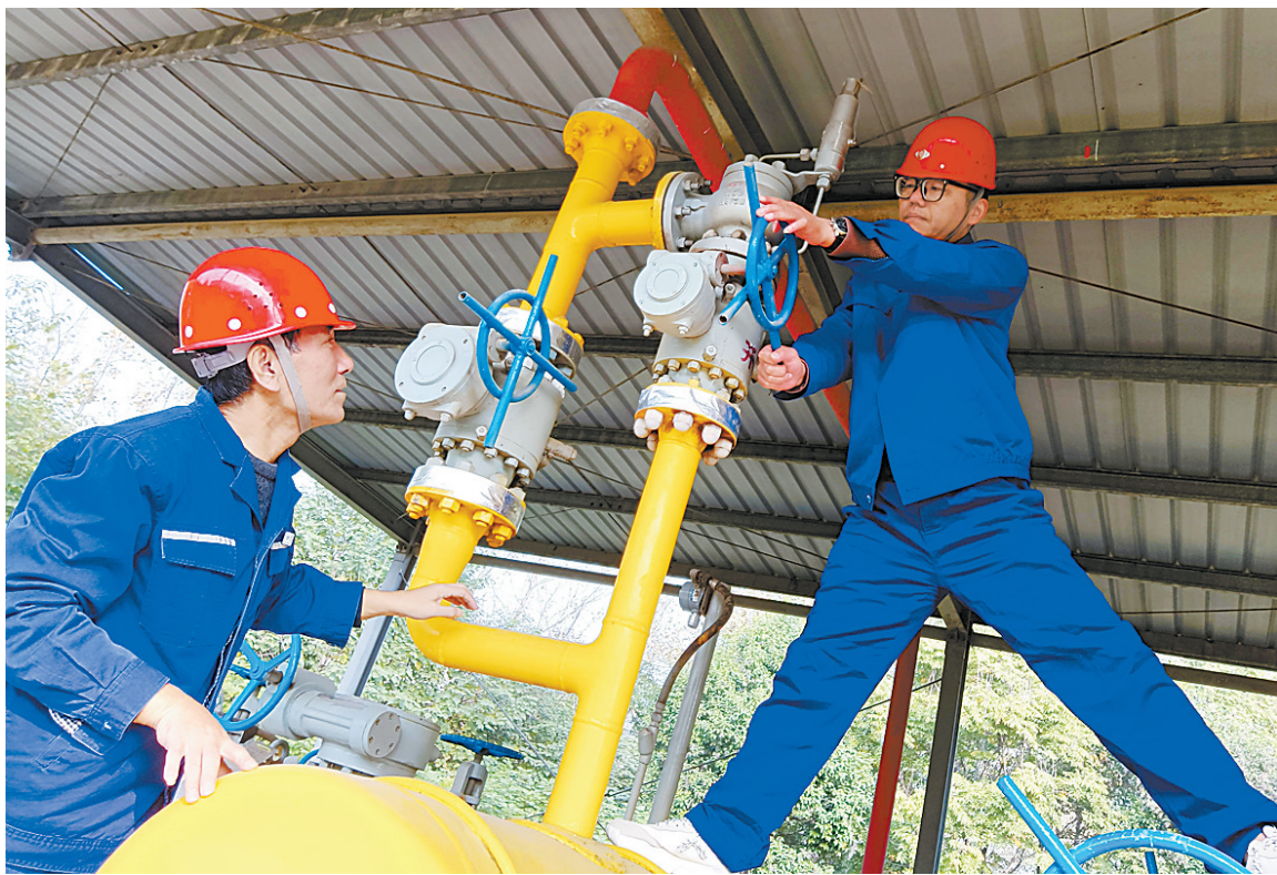
平顶山燃气公司维修人员对管网进行常规检修,确保安全平稳供气。
