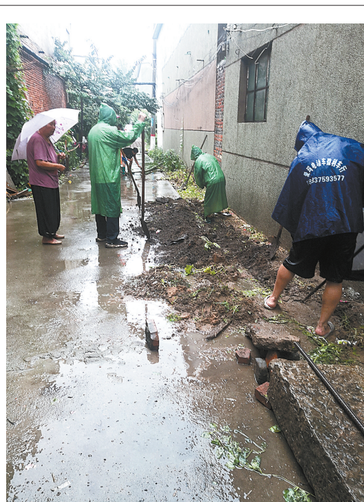
五矿附近泄洪沟堵塞,致使谢庄村三组突发积水,谢庄村“两委”派人紧急进行疏通
