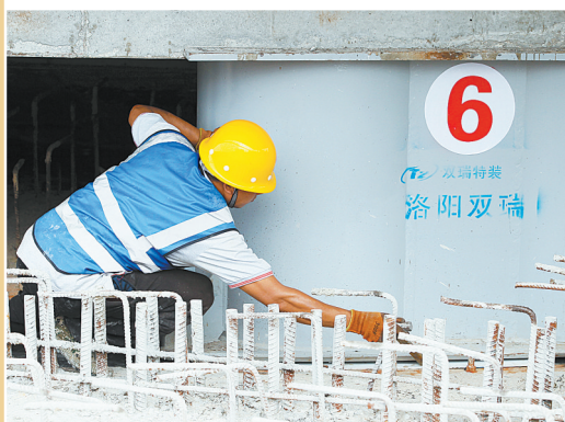
施工人员为主梁下方的转动滑轮跟随铺设涂了油的垫片,减少转体移动产生的摩擦力
