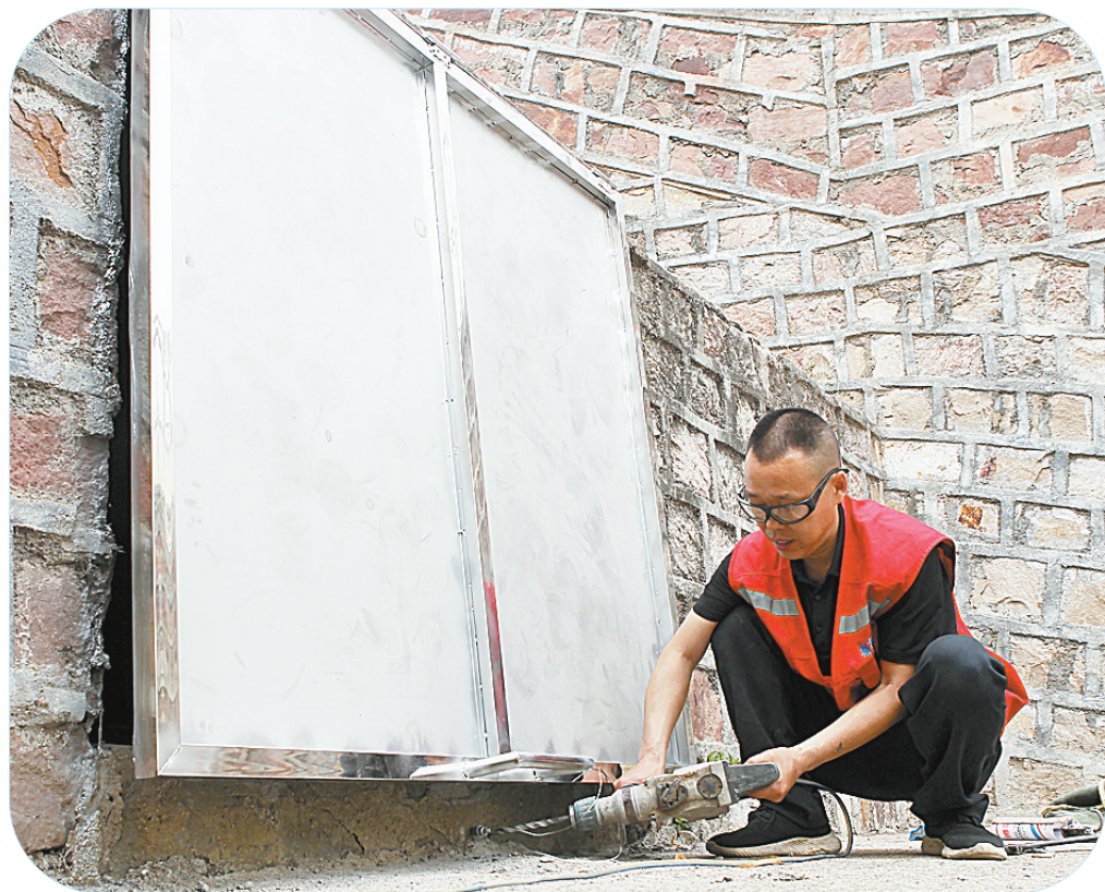
5月10日,在市区光明路湛河桥北侧,市城管局市政维修二队的施工人员在为桥下的污水暗涵溢流口加装盖板。 本报记者 李英平 摄
