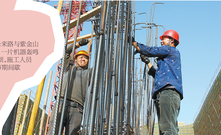
2月22日,在市一高附属初中工地,施工人员忙碌着捆扎钢筋立柱。
