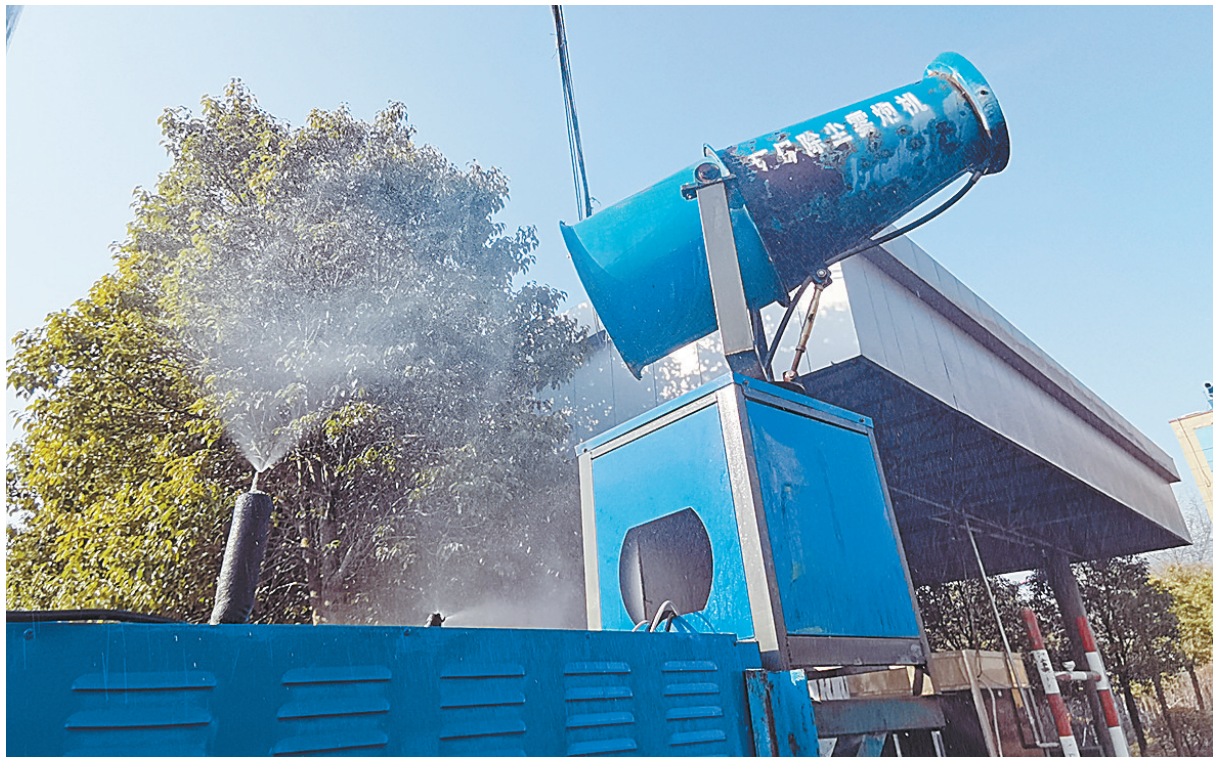
12月21日,新华区一家企业的喷淋设施正在作业
