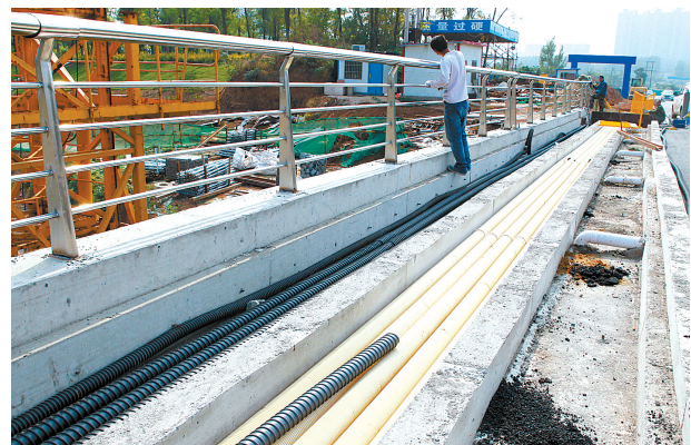
2018年10月,施工人员在安装稻香路湛河桥护栏的同时,在人行道下铺设弱电管线。
