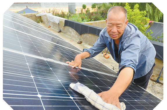
身有残疾的村民张国福在家里房顶擦拭光伏发电板，他家里装了5000瓦的光伏发电设备，年平均收益3000元。
