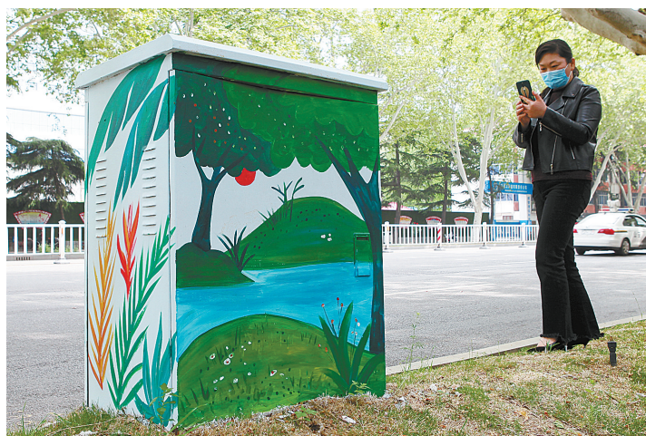
建设路中段,一位市民用手机拍摄彩绘路灯配电箱
