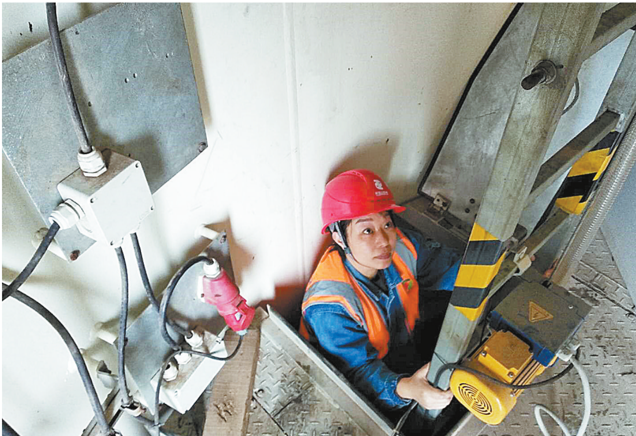
高晓燕下到风力发电机塔筒底部查看设备情况 图片由受访者提供
