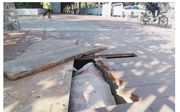
损坏的桥面 本报记者 李英平 摄
