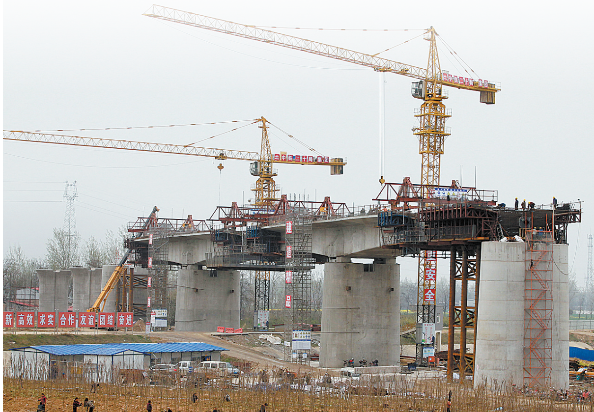
2017年4月5日,中铁二十局的员工在进行郑渝高铁北汝河大桥桥梁架设施工。
