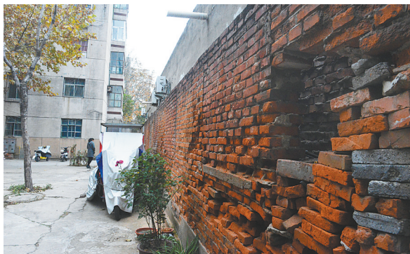
新华区曙光街40号院里的围墙破旧不堪。
