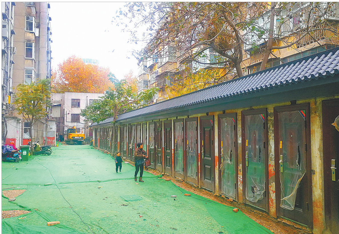
建东小区61号楼前,原来破旧混乱的车子棚正在被改造为坚固整齐实用的停车场。
