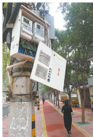
变压器考核表的表箱盖脱落,靠一条布绳维系着悬吊在半空中。 本报记者 李英平 摄
