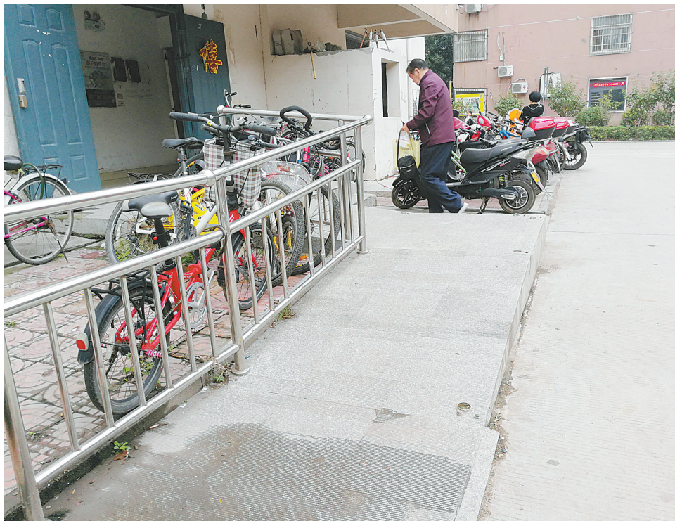
楼栋入口处,无障碍通道护栏缺失
