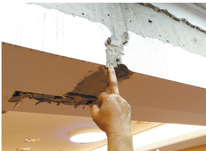
住宅主梁出现裂缝 本报记者 张鹏 摄
