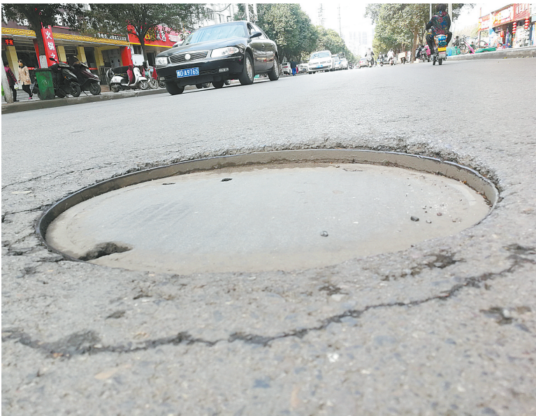
昨天，记者在市区湛南路西段倾城小区大门口西侧看到，位于马路中央的两个窨井盖严重下陷，形成了深三四厘米的坑槽。
