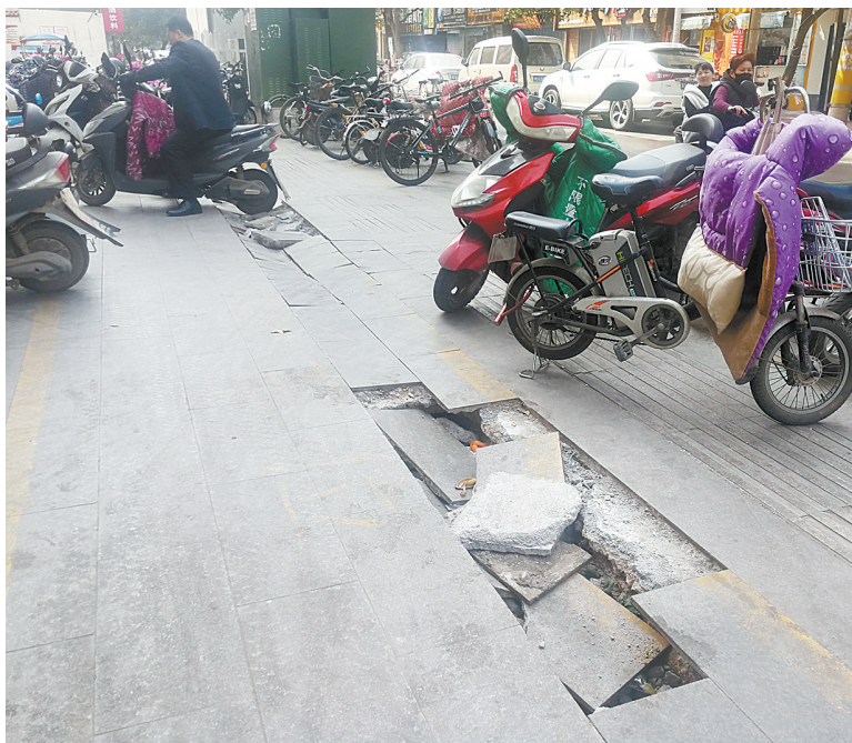
昨天，市区公园北街路边人行道地面塌陷出现的“沟”。本报记者 禹舸 摄
