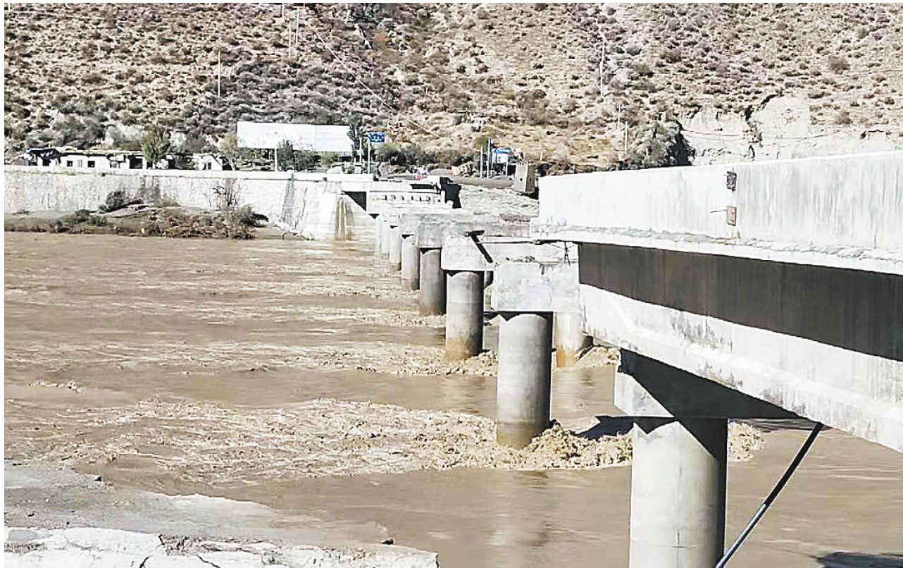
这是被洪水冲毁的竹巴笼大桥(11月14日摄)。记者从四川省交通运输厅公路局了解到,位于四川甘孜藏族自治州的国道 318 线竹巴笼金沙江大桥,因白格堰塞湖泄洪造成 7 跨梁板被冲毁,致国道 318 线断道。新华社发
