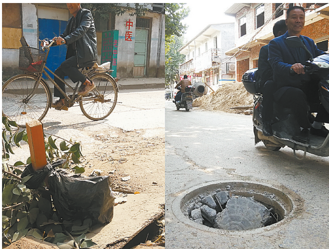
东环路南段仁睿井盖破损
