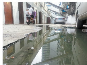
昨天,大量的污水从湛南路168号院居民楼前淤塞的窨井中漫出,人们只好靠着墙根出入。
