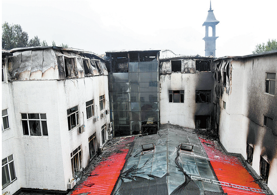
这是 8 月 25 日拍摄的酒店发生火灾的客房楼体
