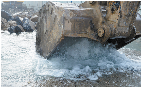
挖掘机下,清水从被挖破的供水管道中喷涌而出。
