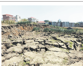
现场出现不规则裂缝
