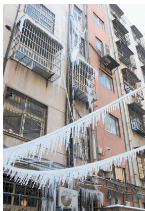
大量的水从5楼冻裂管道中流出,使周边的楼体和电线挂满了长短不一的冰柱。
