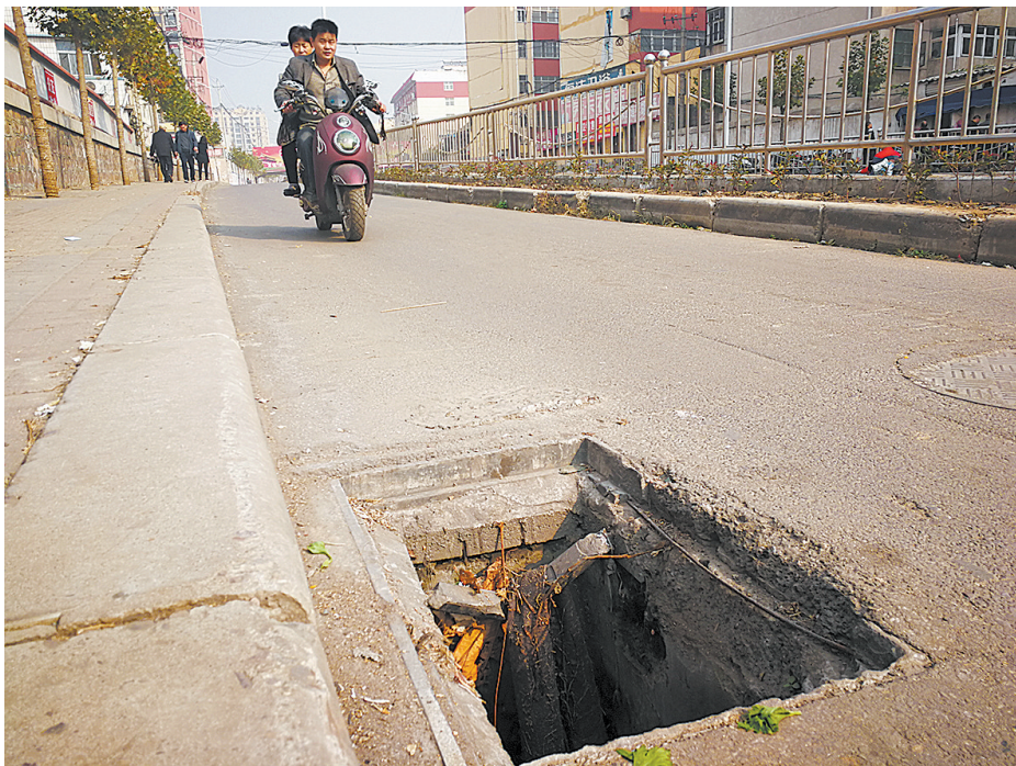
▲一矿路南段平煤铁路立交桥匝道上有个缺失雨水算子的坑
