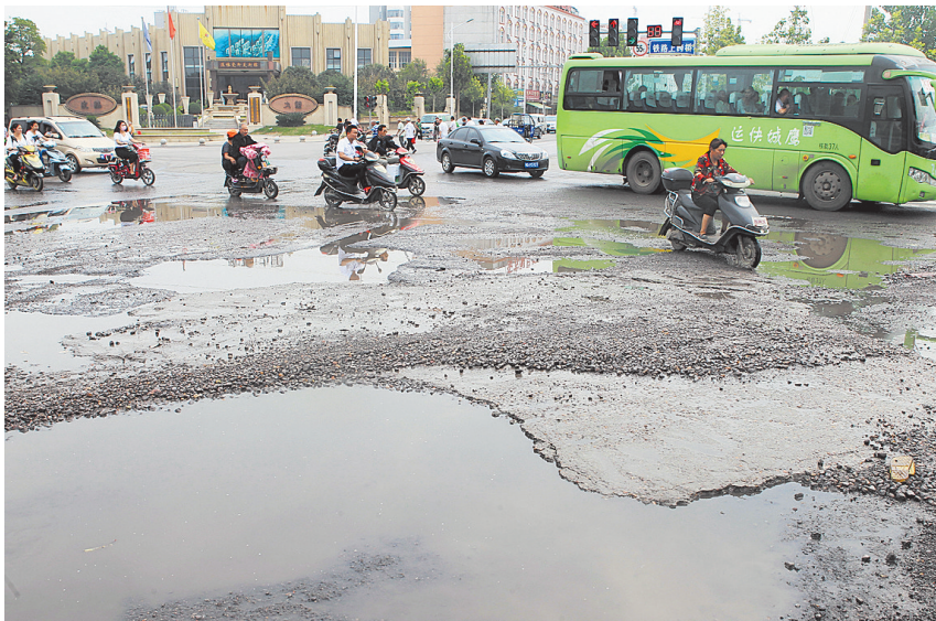
市区光明路与黄河路交叉口西南侧，大片路面破损积水，坑洼不平。
