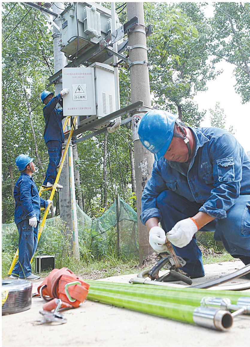
▲供电工人正在检查杜谢村中的变压器
