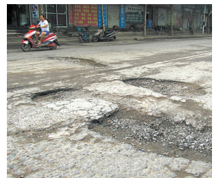
开发二路上坑连坑
