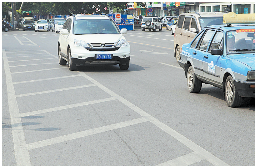
▲这是位于光明路与湛南路交叉口的导流线。导流线是为机动车有序分流设置的,出现在市区多个路口。一些车主经常在上面行驶甚至停车,这些违规行为一旦被监控设备或交警抓拍,将被处以扣6分、罚款200元的处罚。
