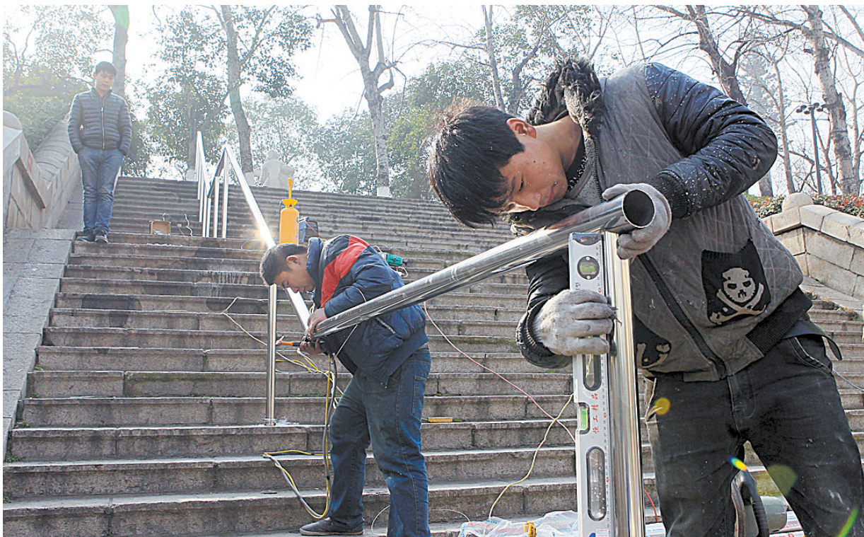
昨天,施工人员在安装体育路湛河堤北岸台阶的不锈钢扶手。 本报记者 李英平 摄
