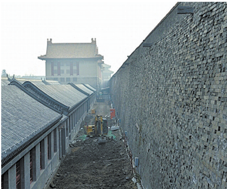
故宫西华门北侧待修的城墙破损严重
