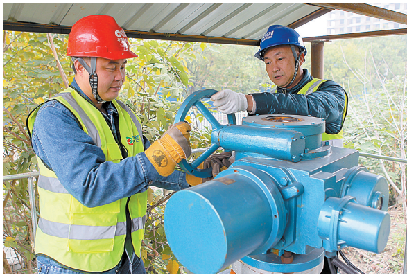
昨天,在平顶山热力集团总控制点,工作人员拧开供热管道总阀门,市区又一个集中供热采暖季正式开始。本报记者 李英平 摄
