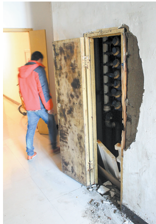
记者在金城丽景小区11号楼5楼看到,由于水表间漏水严重,造成房间大门霉变,墙体大面积脱落。
