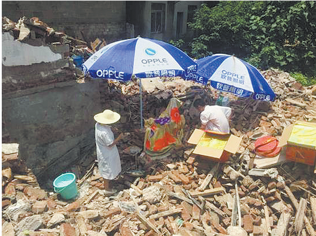
房屋拆迁废墟
