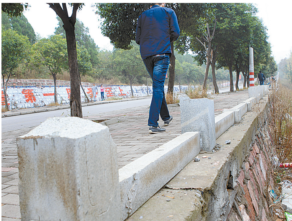
10月8日,记者在新华路北端通往山顶公园路段看到,道路一侧的花岗岩护栏多处发生损毁。
