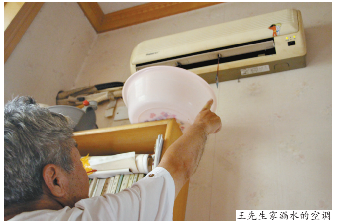
王先生家漏水的空调
