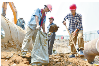
6月10日,自来水工程处的工人在凌云供水路南段改造现场清理泥土。
