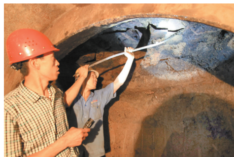
虽然工程可以使用机械掘进,但遇到石块等复杂地质层,只能人工挖掘。
