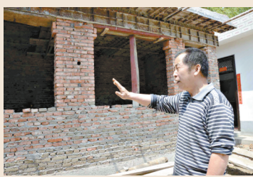
▲岳石头向记者介绍正在建设中的丝绸展馆，建成后将成为我省展示传统丝绸生产工艺的唯一展馆。
