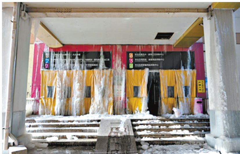
大楼一层入口处,因连续喷水灭火,门帘上结满冰。
