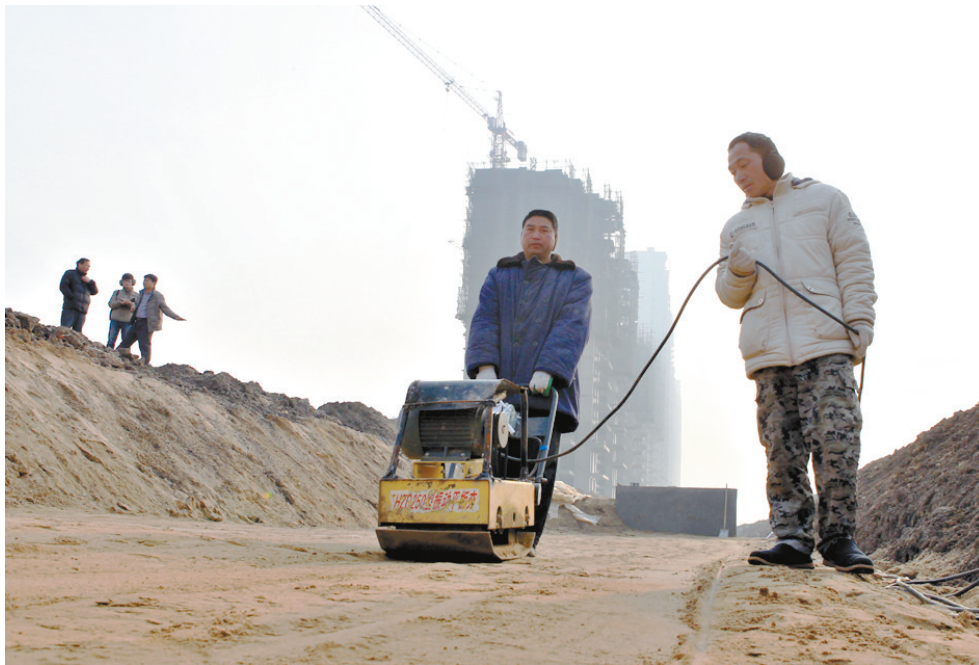
在焦店村南侧的湛河治理施工工地,排污暗涵铺设已经完成,承担施工的市市政工程有限公司职工在奔走上岸。
