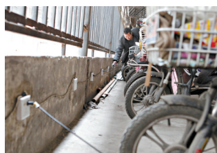
一位居民正在车棚内使用专用插座为电动自行车充电。
